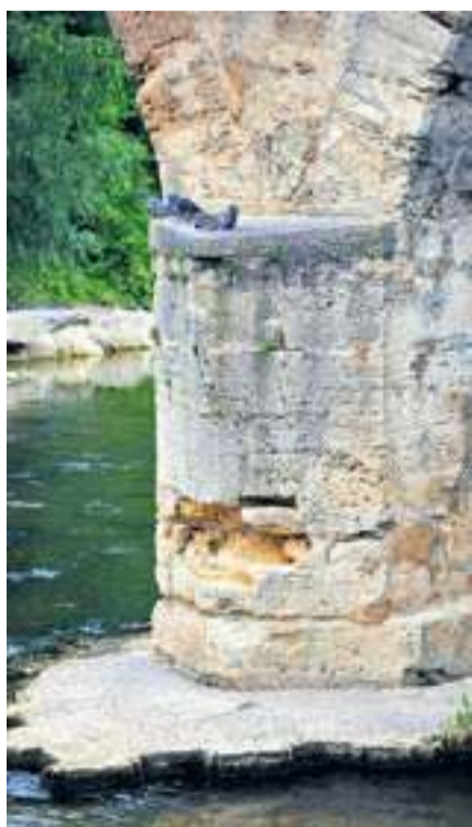
Schwemmholz beschädigte einen Pfeiler der Alten Brücke. Bild: Marc Dahinden
